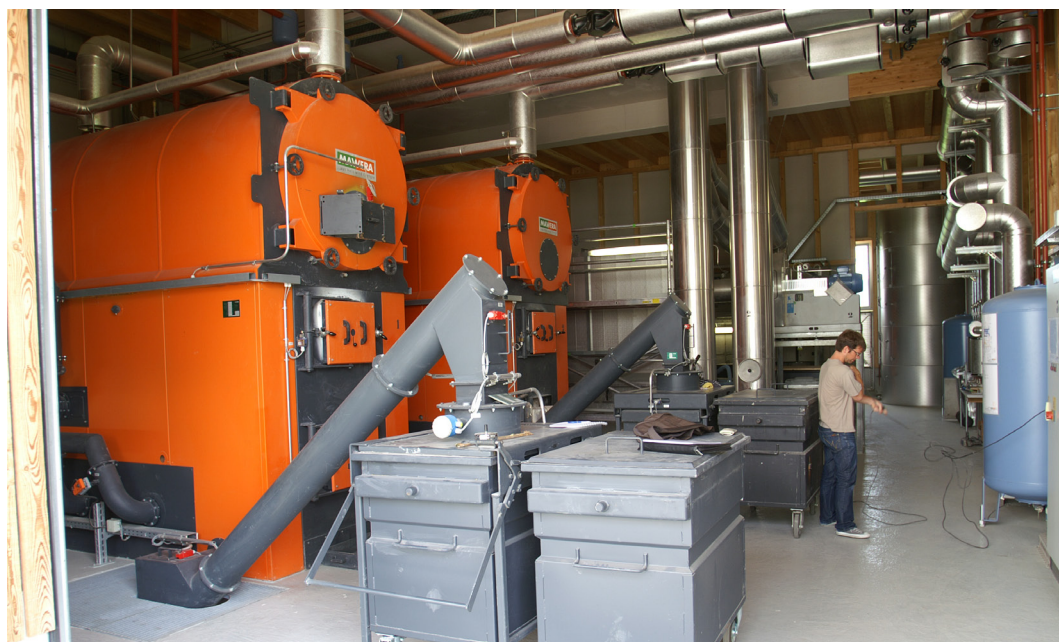
Die beiden Hauptkessel des Wärmeverbunds Kägiswil mit je 1100 kW Leistung. Sie decken in der Heizperiode rund die Hälfte des Wärmebedarfs von Kägiswil (OW). Foto: B. Vogel
