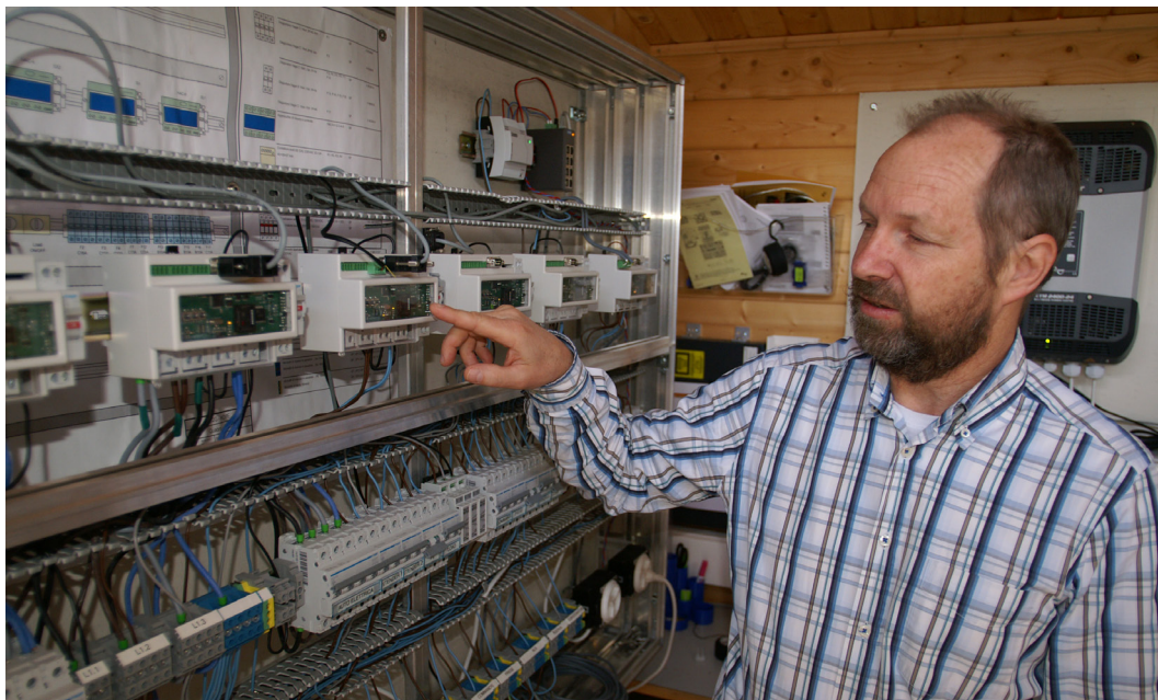
SUPSI-Forscher Dr. Roman Rudel zeigt auf die Smart Meter, die an ausgewählten Netzpunkten die Spannung messen und daraus Steuerungsbefehle für Elektrogeräte ableiten. Foto: B. Vogel
