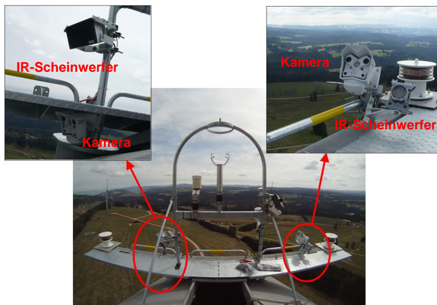
Abb. 1: Installierte Kameras und IR-Scheinwerfer auf der Gondel der WEA in St. Brais. Links: Auf das Rotorblatt gerichtete Kamera. Rechts: Auf die Sensoren gerichtete Kamera.
