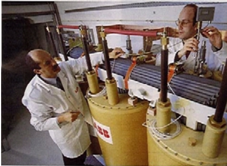
fig.1 : Prototype 630 kVA dans les locaux des Services Industriels de Genève (1997)
